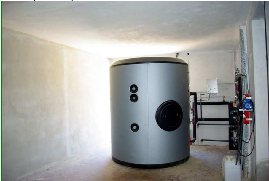
Figura 3. Depósito de frío
