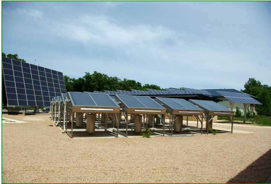
Figura 1: Generadores de frío y fotovoltaico
