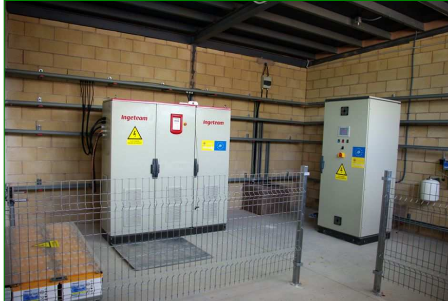
Figura 8. Acondicionador de potencia y control del electrolizador
